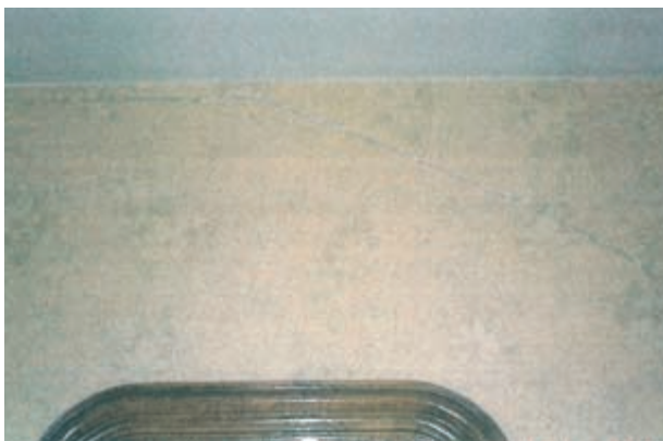
Fissuration intérieure, tapisserie déchirée - Maison André.
