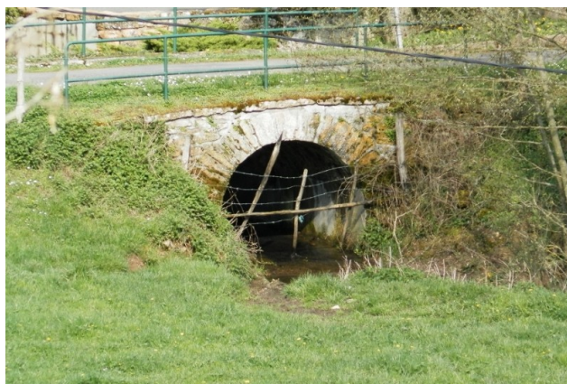
Un clôture de barbelés obstruant l'exutoire du pont du Moulin.
