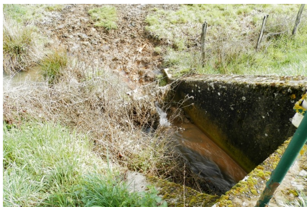
Végétation et clôture de barbelés faisant office de piège à embâcle au niveau du pont de la route des Bruyères.
