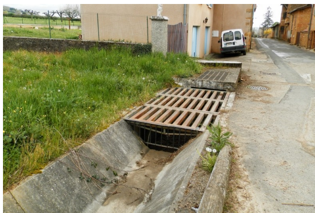
Fossé canalisant les écoulements issus du ruissellement dans les vignes, au niveau de la route de La Rochelle. Le dispositif installé est vulnérable, en cas de colmatage, les eaux peuvent se déverser sur la route et les terrains en contrebas.
